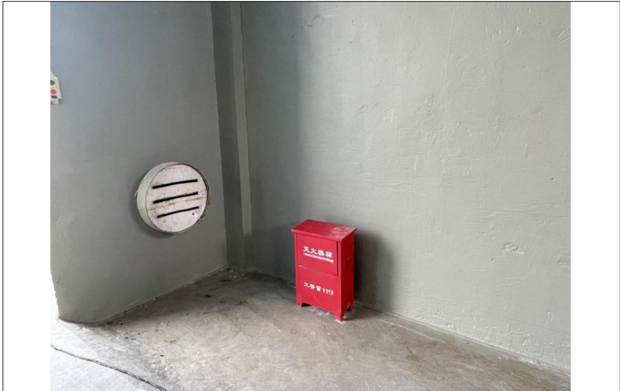
危废库内消防设施
