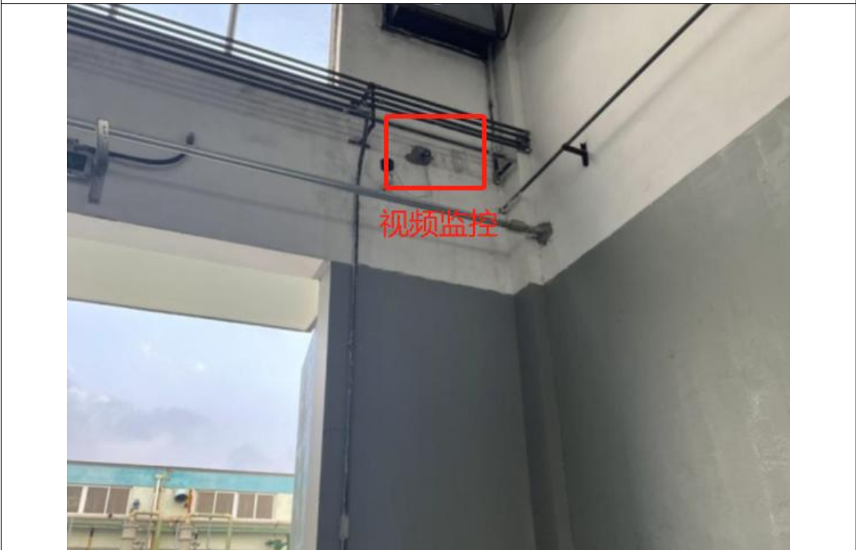
危废库内视频监控
