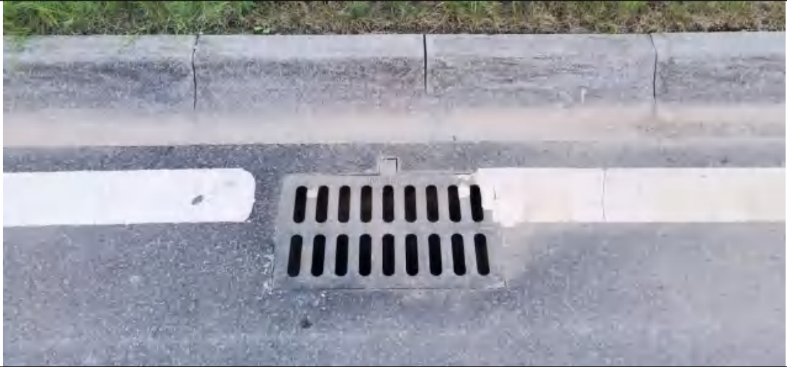
项目区排水管线（2021.07）
