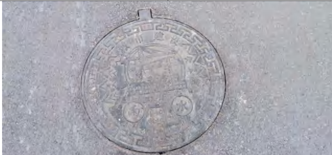
项目区排水管线 (2021.07)
